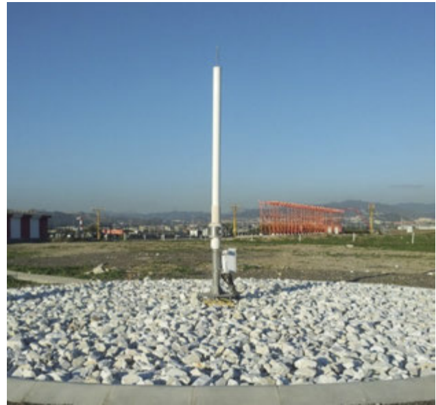
Figura 4: Antena receptora de señal de satélite. Sistema GBAS del aeropuerto de Málaga-Costa del Sol. (Fuente: ENAIRE)
