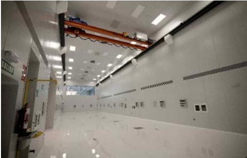
■ Figura 8: una de las dos salas limpias del edificio IACTEC
